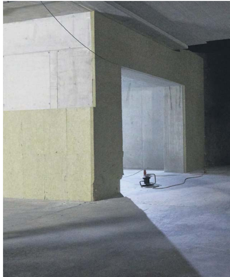
Multifunktionsstelle Sedrun: Sie und ihre «Schwester» in Faido sind wichtige Drehscheiben für
