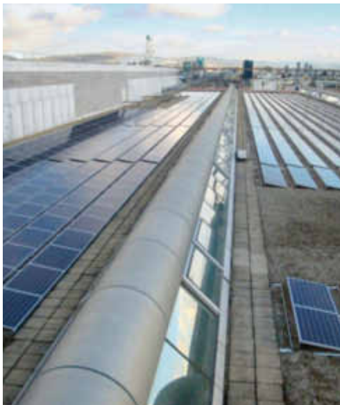
Energia solare per 370 utenze domestiche dal tetto del Centro lettere Zurigo-Mülligen.
