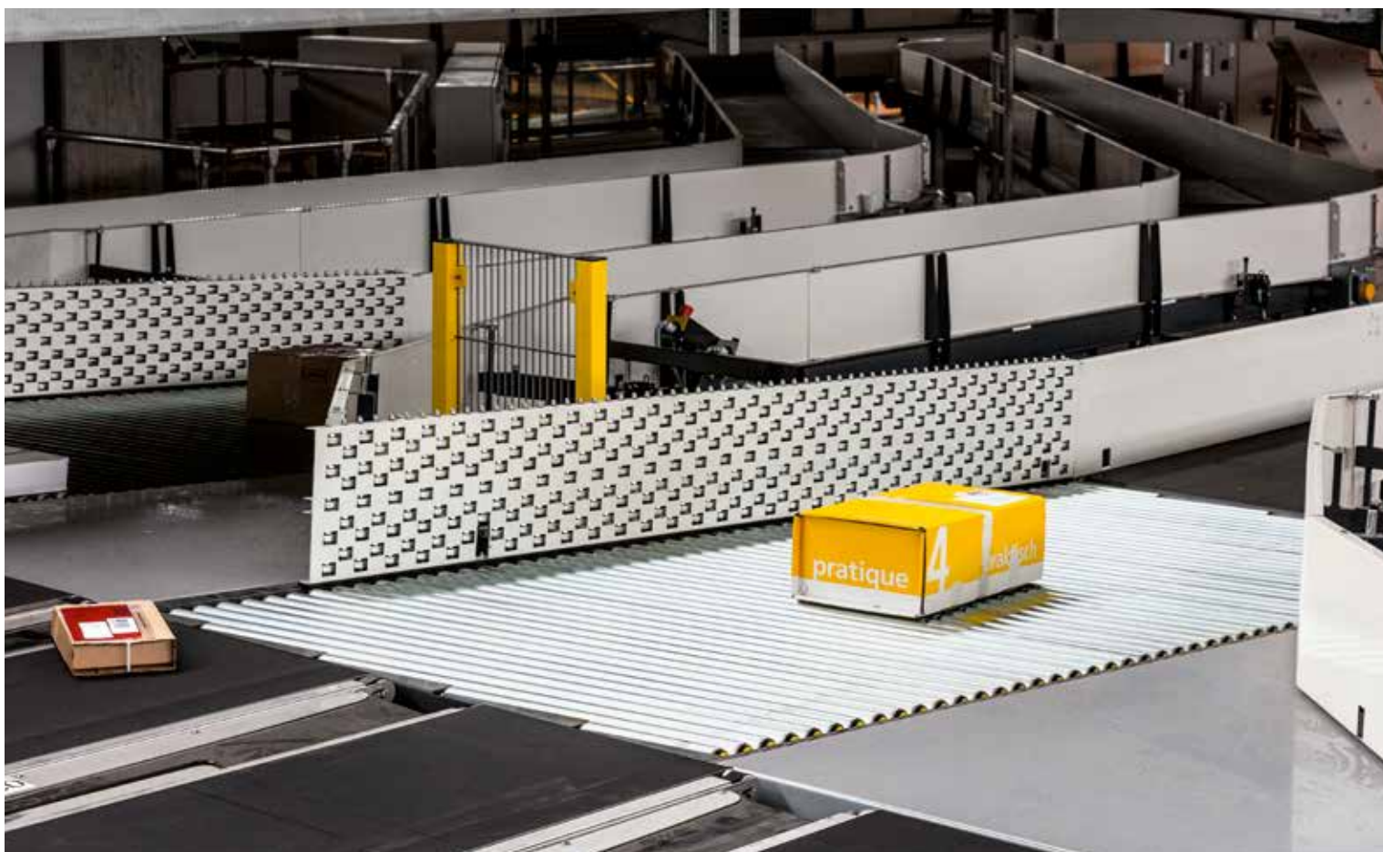
Elabora 25 000 pacchi all'ora: è l'impianto di spartizione ampliato di Härkingen.
