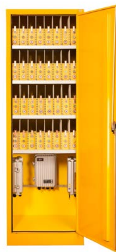
Stromspeicher aus alten Postrollerbatterien (Masse: 195x64 cm).
